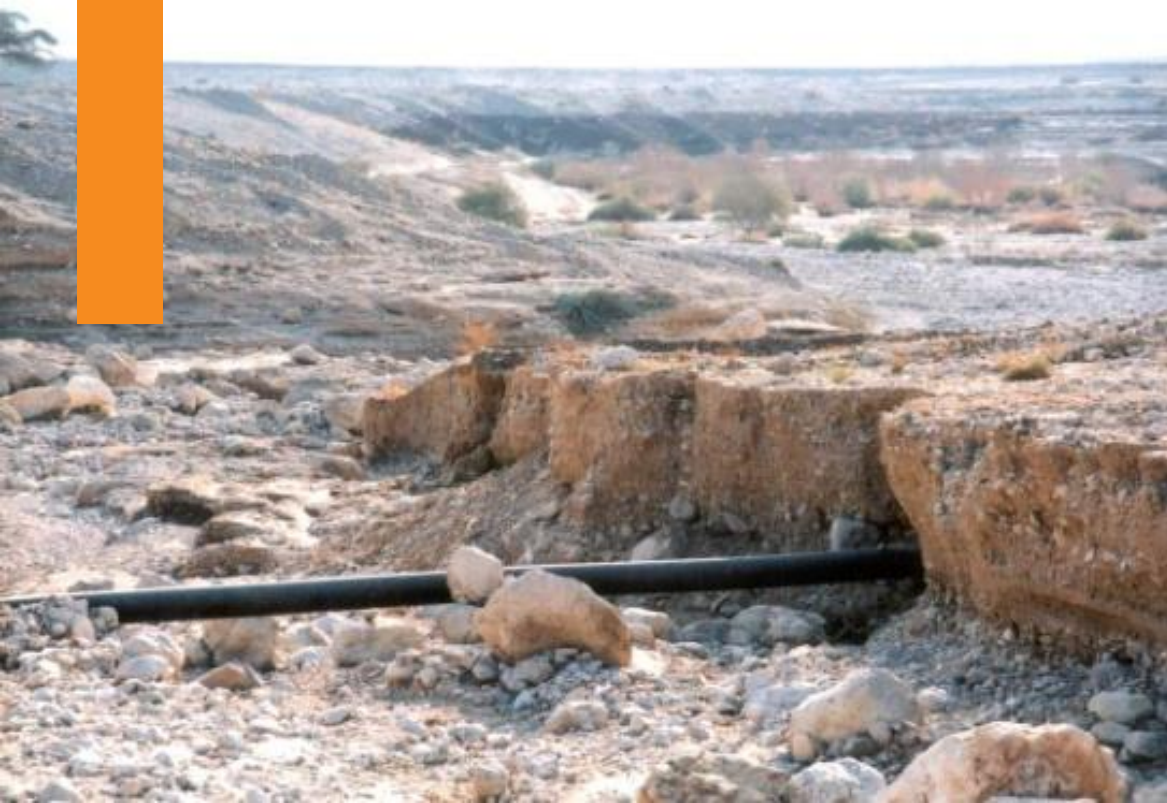
Las tuberías de Pexgol resisten las inundaciones en Wadi Rajaf, Israel Tubería Pexgol de 315 mm desde 1992
